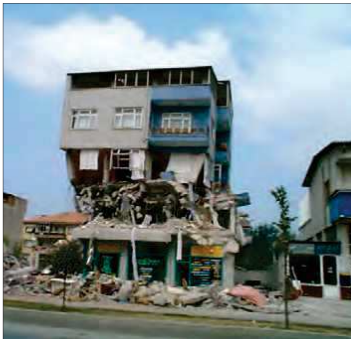
Figura 4.35 Danno gravissimo a struttura a telaio di cemento armato, con distruzione di parte dei pilastri del primo piano e del solaio del secondo. Livello del danno: D4- D5 (Turchia, 1999)
