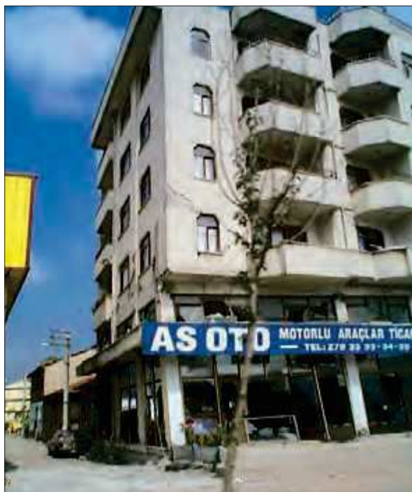
Figura 4.30 Danno gravissimo ad edificio con struttura a telai in cemento armato (piano debole); fuori piombo e formazione di cerniere plastiche in testa e al piede di gran parte dei pilastri del piano terra. Livello del danno: D4-D5 (Turchia, 1999)
