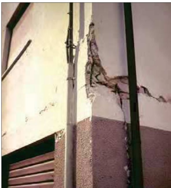
Figura 4.31 Danno all'attacco di un pilastro in corrispondenza della ripresa di getto; espulsione di materiale, lesione orizzontale e inizio di sbandamento delle barre. Livello del danno alle strutture verticali tendente a D4 (Fabriano, 1997)
