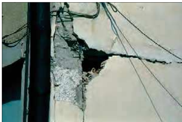
Figura 4.29 Danno al nodo e all'attacco del pilastro con espulsione del materiale fino al nucleo. Livello del danno alle strutture verticali: D4 (Atene, 1999)
