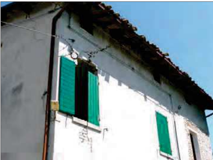
Figura 4.13 Lesione con distacco di spigolo sottotetto (tipo 9). Livello di danno: D3
