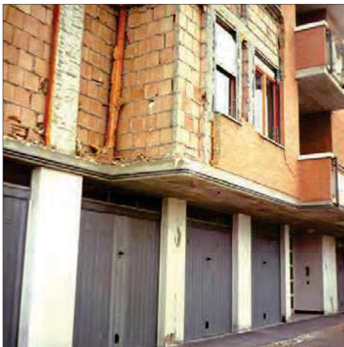
Figura 4.34 Ribaltamento totale di tamponatura esterna non collegata alla struttura principale. Livello del danno per le tamponature: D4 (Fabriano, 1997)
