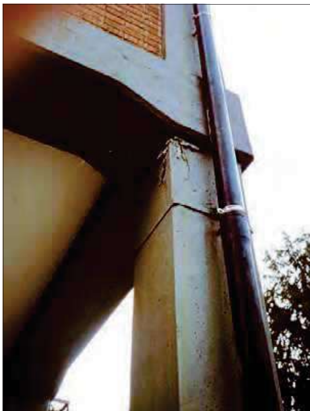
Figura 4.28 Espulsione di copriferro in testa al pilastro, accompagnata da lievi lesioni verticali. Livello del danno: D2-D3 (Bagnolo, RE, 1996)
