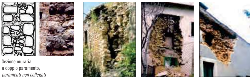
Fig. 3.2 – Ps: sezione a paramenti con elementi scollegati o male ammassati come evidenziato da crolli rovinosi provocati dal sisma
