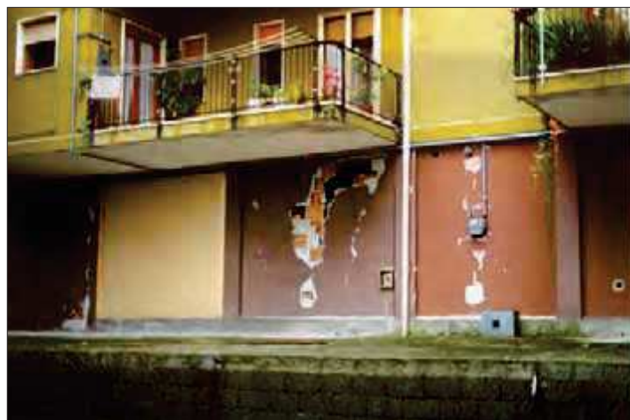
Figura 4.33 Lesioni molto gravi in tamponature deboli. Livello del danno alle tamponature: D4 poco diffuso (Umbria, 1997)
